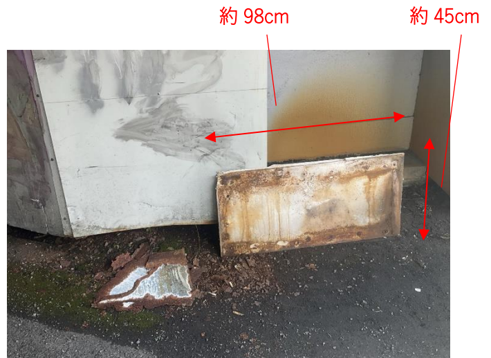
〔落下物（ケイ酸カルシウム板）〕
