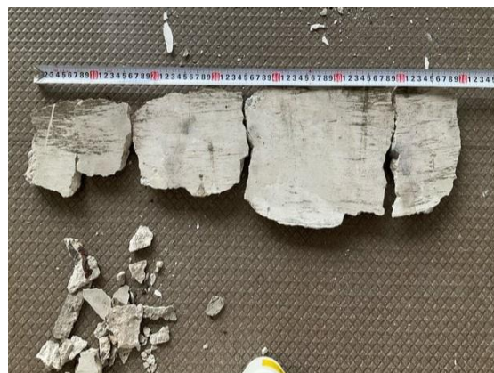
写真 2 落下したコンクリート片
