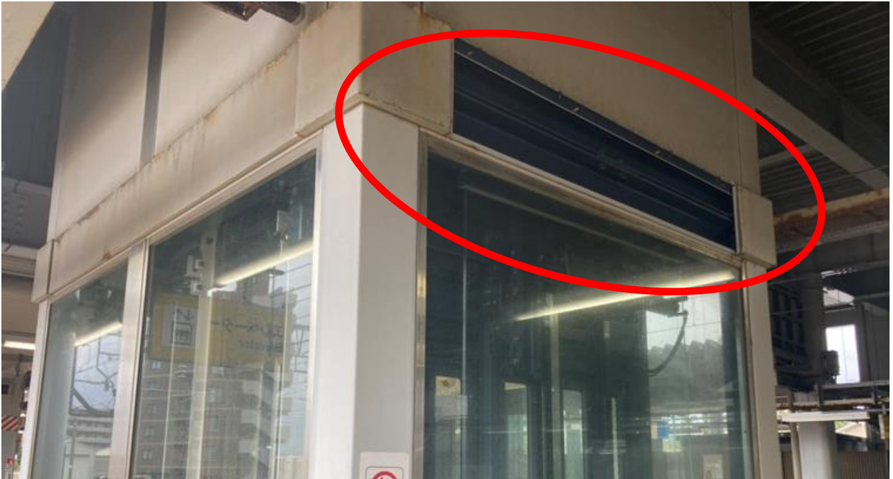
■ エレベータ外側パネルの設置位置
