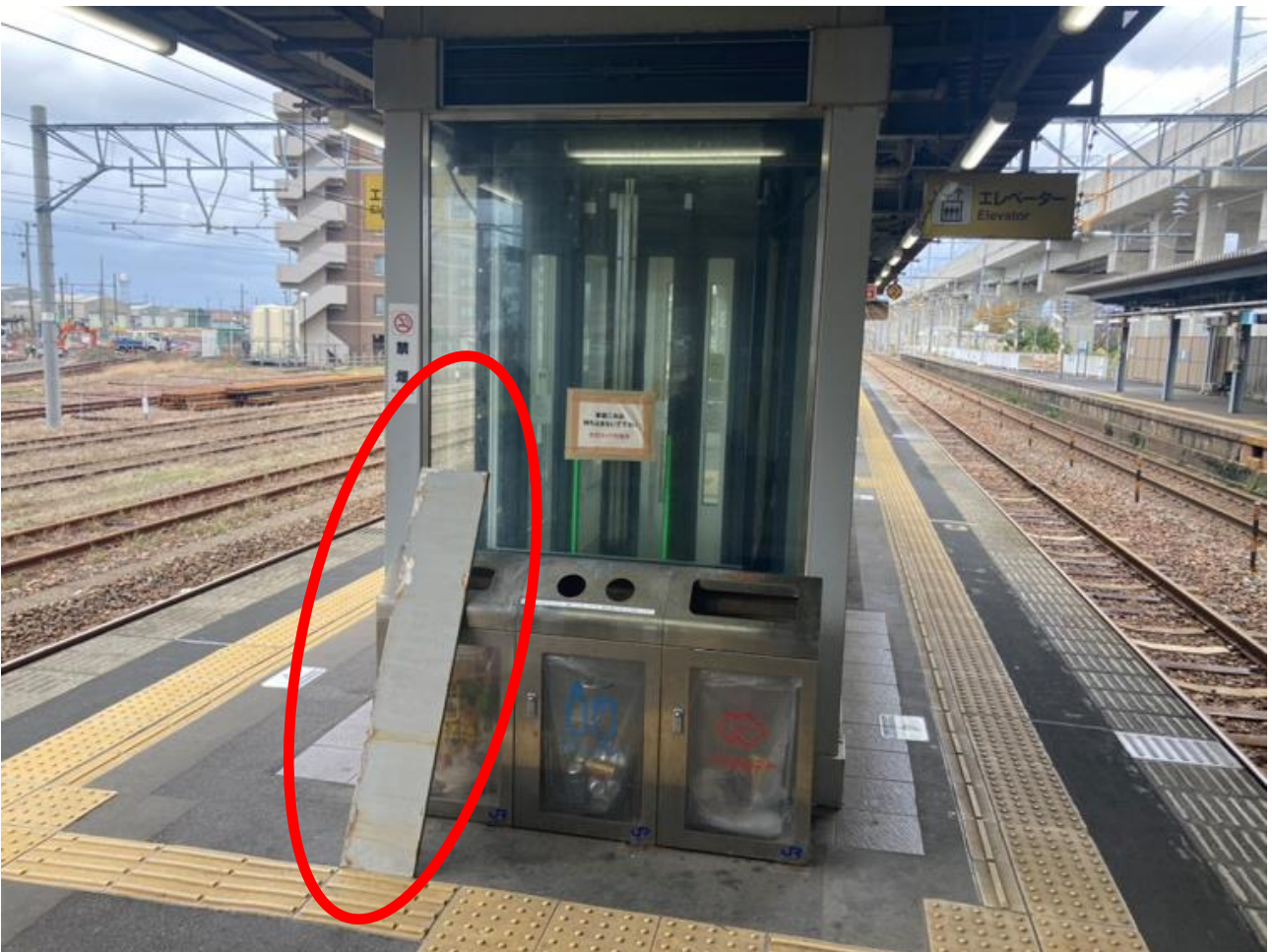
■ 落下したエレベータ外側パネル
