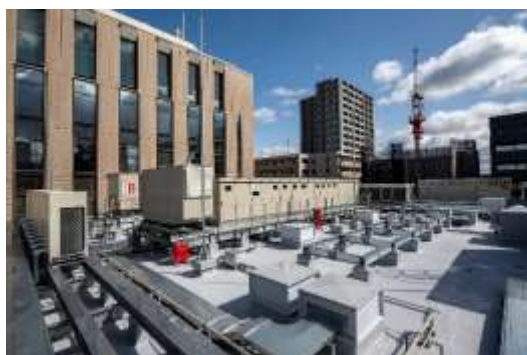
屋上 非常用発電機
