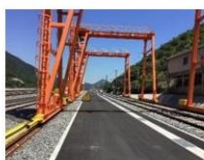
移動式門型クレーン
