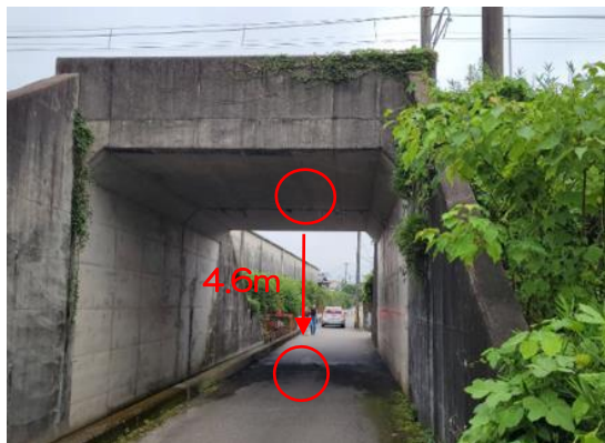
① 落下箇所（全景）
