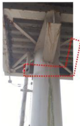
落下箇所(落下後)
