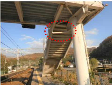
落下箇所(落下前)
