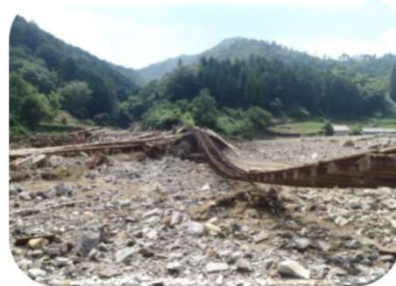
H25.7.28 山口島根豪雨災害 (島根県津和野町)
