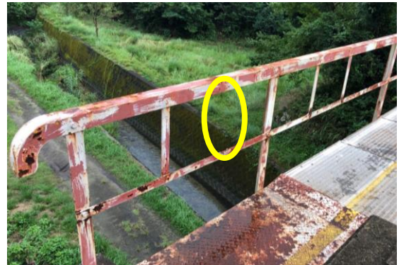
②脱落箇所
