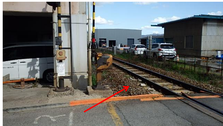
写真-3 落下状況
