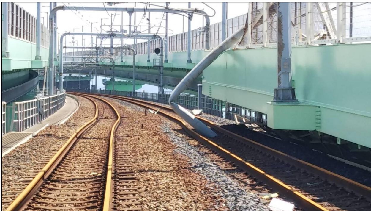
関西空港線 りんこうタウン駅～関西空港駅間 関空連絡橋の被災箇所
