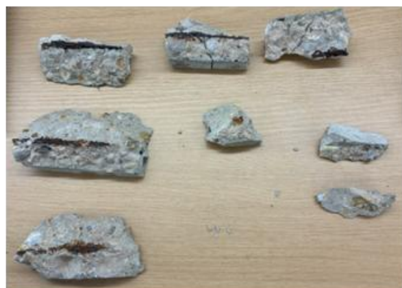
落下したコンクリート片
