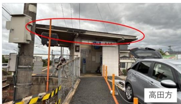
〔コンクリートの剥離箇所〕
