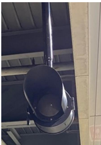
[設置個所・通常の状態]
