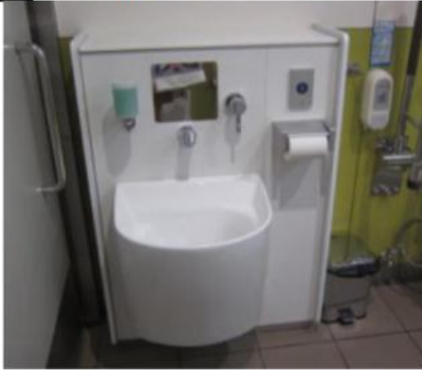
参考写真 オストメイト用設備
