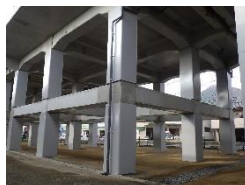
高架橋柱 (せん断破壊先行型)
