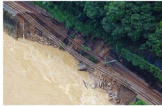
山陽線(本郷～河内駅間) 冠水
