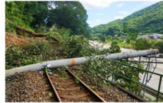
伯備線(備中高梁～木野山駅間) コンクリート柱折損・土砂流入
