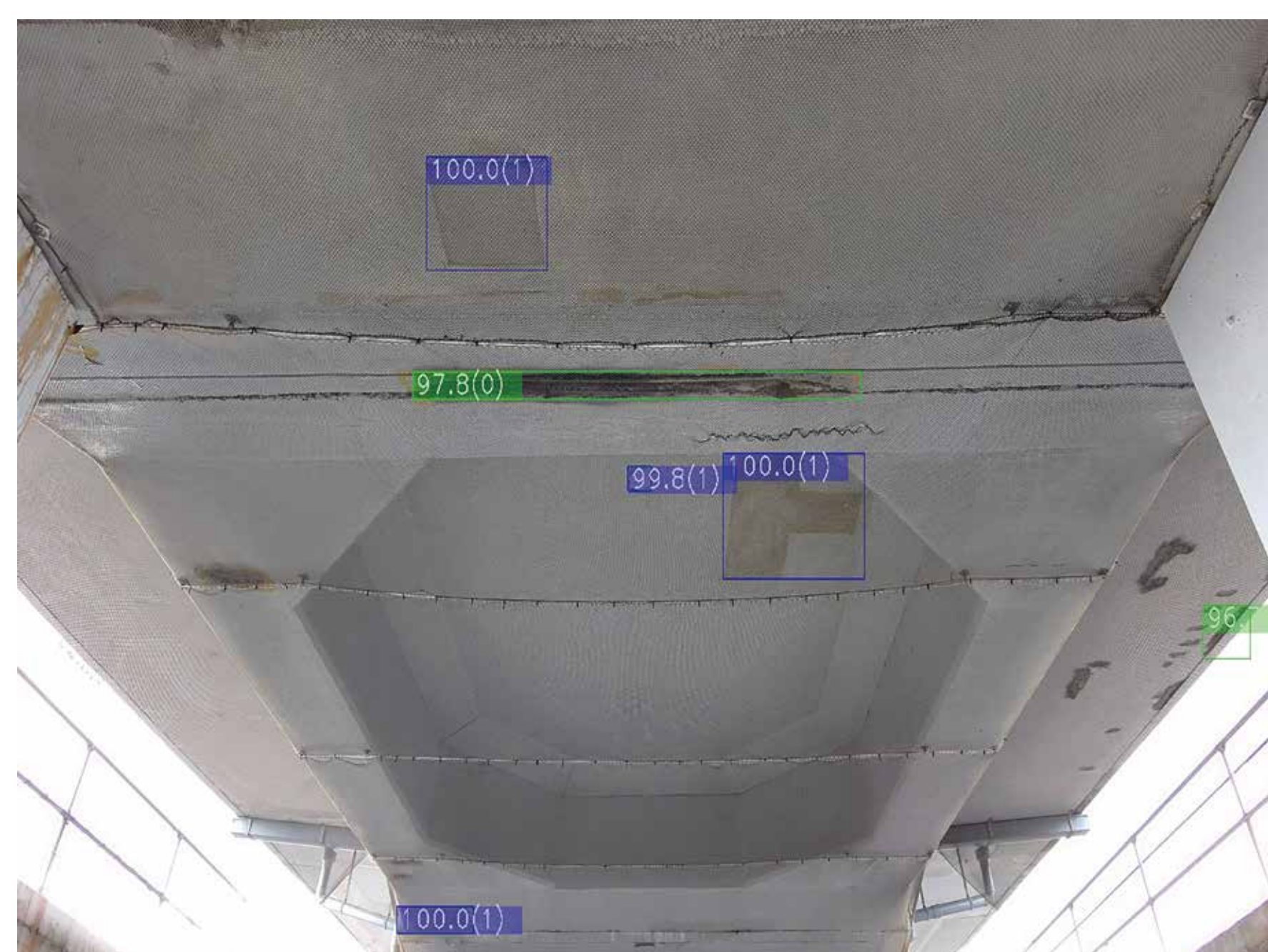
【AIによる変状（鉄筋露出等）抽出】
