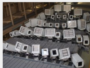
写真6: 電気設備撮像装置
