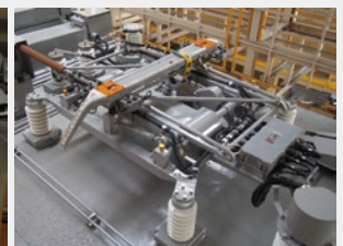
写真7: 電力測定装置
