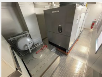
写真5: 検測用エンジン発電機
