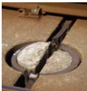
写真1：変状が生じている突起
