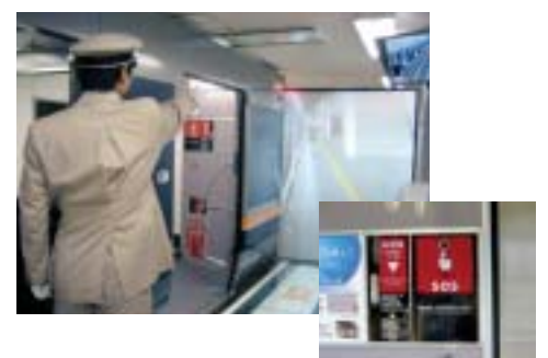
客室内非常通報装置
