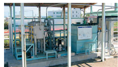
米子施設区では、西鳥取車両支部の排水処理装置の老朽取り替えにおいて、環境に配慮した検討を行い、エネルギー消費量が少ない電解処理方式を採用しました。
