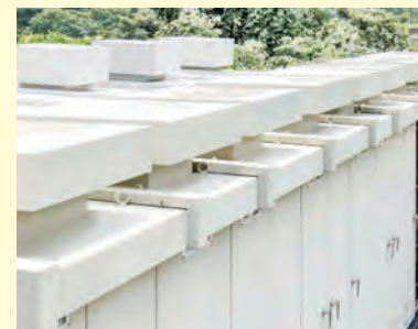
電力貯蔵装置
