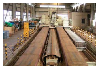
レール再生プラント
