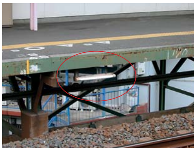
ホーム下LED照明
