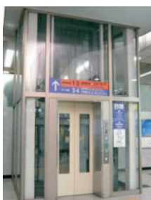
大阪駅御堂筋口エレベーター
