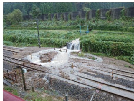
北陸線今庄～湯尾駅間 局地的豪雨による土砂流入
