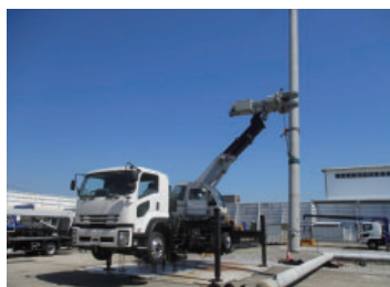
電柱ハンドリング車の導入
