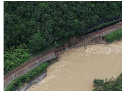
山陽線 本郷～河内駅間 豪雨による盛土流出 (2018年7月 西日本豪雨)
