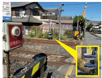
踏切への障害物検知装置の整備
