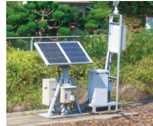
太陽電池を電源に用いた電動塗油器
