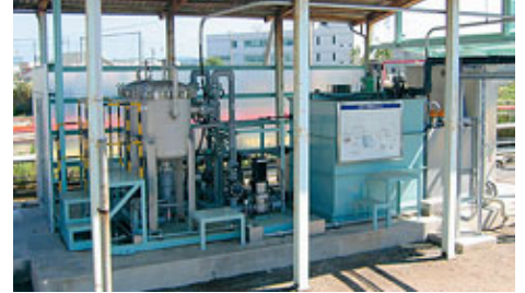
西鳥取車両支部の排水処理装置の老朽取り替えにおいて、環境に配慮した検討を行い、エネルギー消費量が少ない電解処理方式を採用しました。
