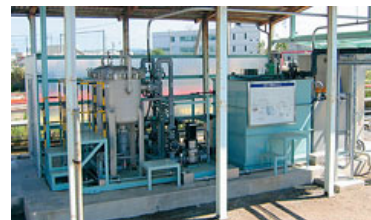
米子施設区では、西鳥取車両支部の排水処理装置の老朽取り替えにおいて、環境に配慮した検討を行い、エネルギー消費量が少ない電解処理方式を採用しました。
