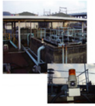
排水処理装置
