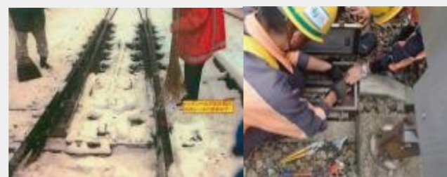
写真4：電気融雪機の検査業務
