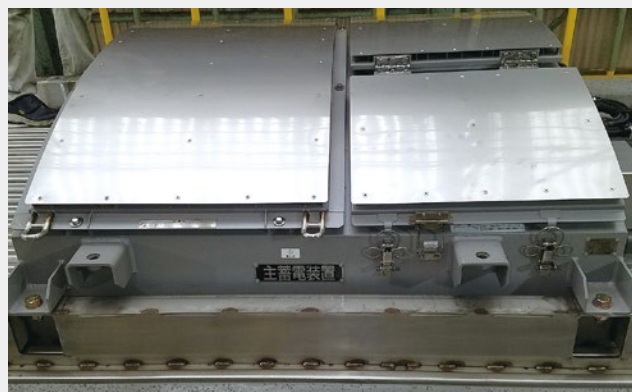
写真3：主蓄電池装置（屋根上）
