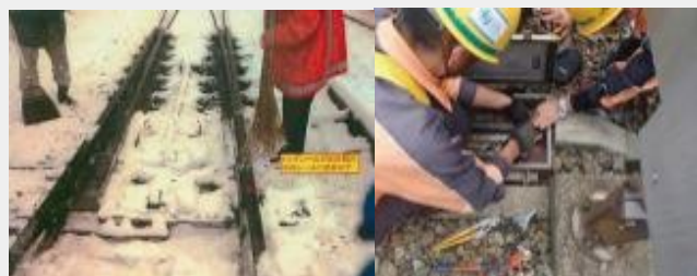
写真4：電気融雪機の検査業務
