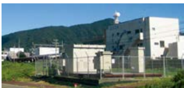
図5：直流電力変換装置の設置状況
