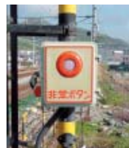
踏切非常ボタン
