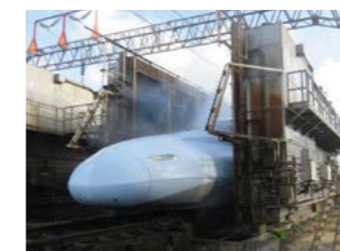
工場排水の再利用による車両洗浄機(新幹線)
