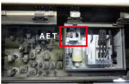
写真1：ブレーキ制御装置
