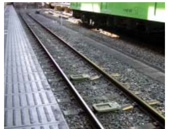
行き止まり線用ATs-SWの地上設備
