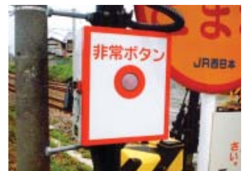
踏切支障報知装置
