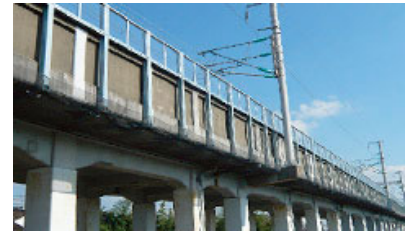
新幹線の防音壁
