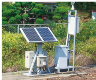
太陽電池を電源に用いた電動塗油器
