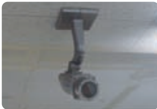
駅等に設置している防犯カメラ
