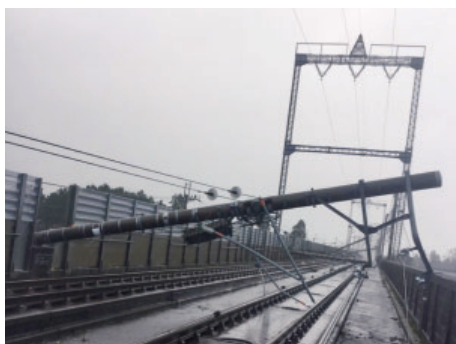
湖西線比良～近江舞子駅間 強風による電化柱倒壊
