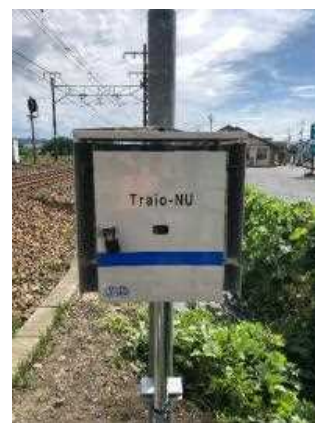
沿線に設置したデータ収集装置
