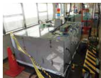
図5：蓄電池システム設置状況(車内)
