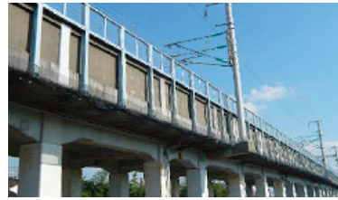
新幹線の防音壁
