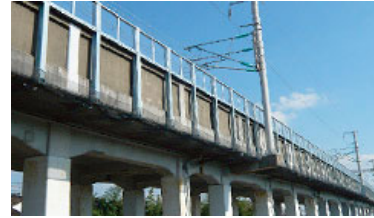
新幹線の防音壁
