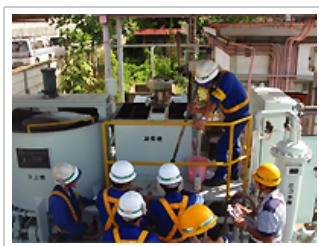
排水処理装置のメンテナンス
