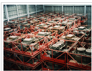
PCB含有機器の保管状況
